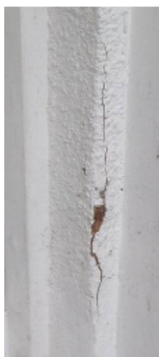
R11 – Cracking RHS front door
