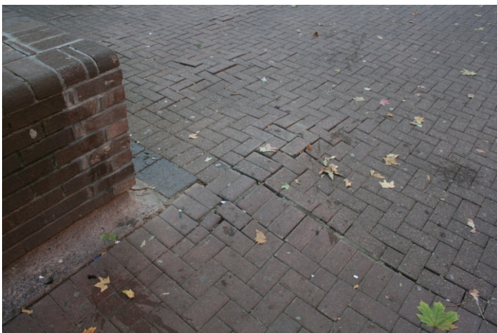
Uneven paving, possible hazard
