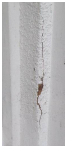
R11 – Cracking RHS front door
